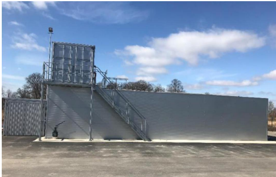
3.23. attēls. Moduļu tipa notekūdeņu attīrīšanas iekārtas
